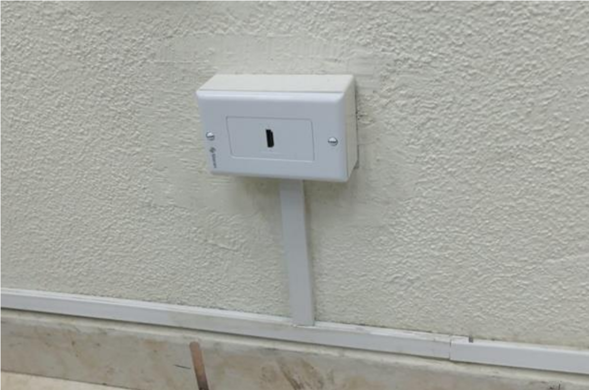
Instalación de caja HDMI para proyección desde equipos portátiles en Sala de Sesiones
