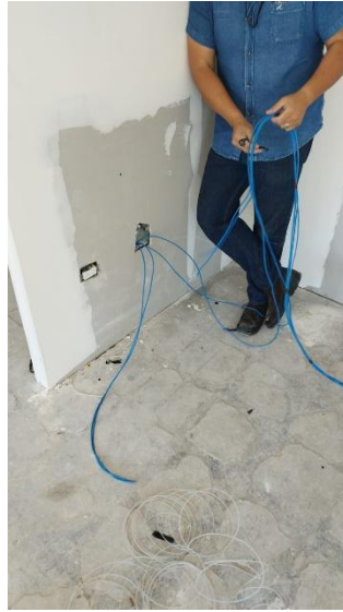
Instalación de cableado estructurado de voz y datos en las nuevas oficinas DETAISPE, DEECE y DEQDPCE
