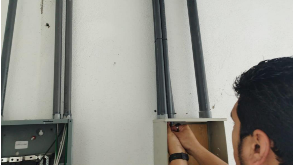
Instalación de cableado estructurado de voz y datos en nuevas oficinas DETAISPE, DEECCE y DEQDPCE
