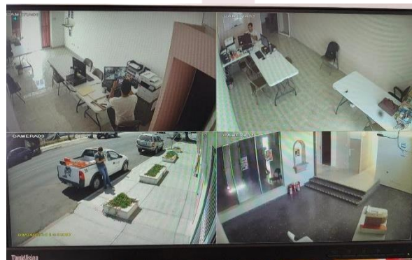
Instalación de cámaras de vigilancia en los Centros de Captura y Verificación de Datos
