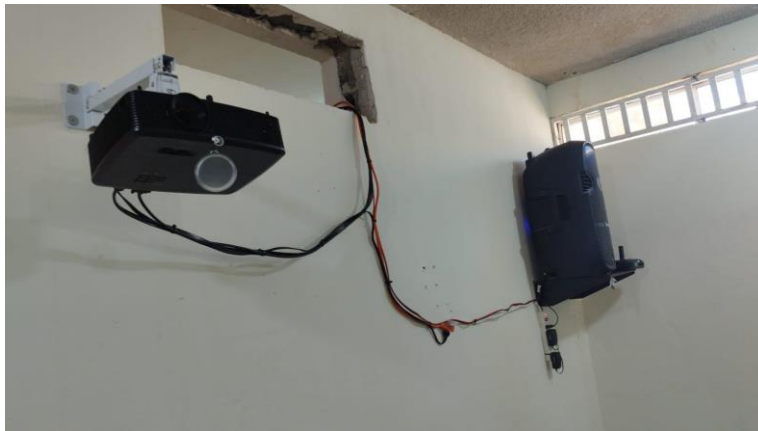
Instalación de equipo de proyección y audio en el CME La Paz
